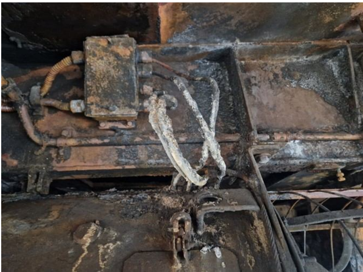
Фиг. 4.18. Силови захранващи кабели на първи подкошов двигател вентилатор
