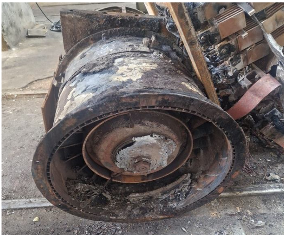
Фиг. 4.10. Изглед на хоризонталния вентилатор след пожара
