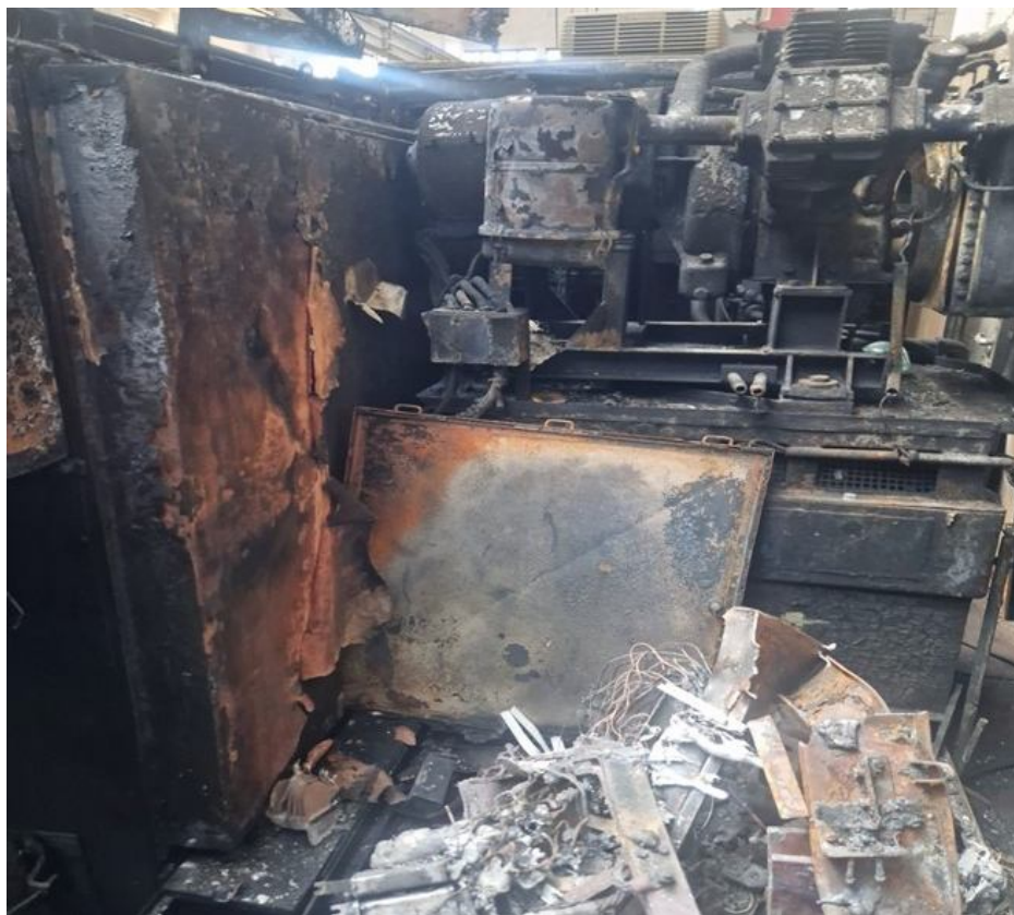
Фиг. 4.6. Изглед на опожарен изправител 022 и 221
